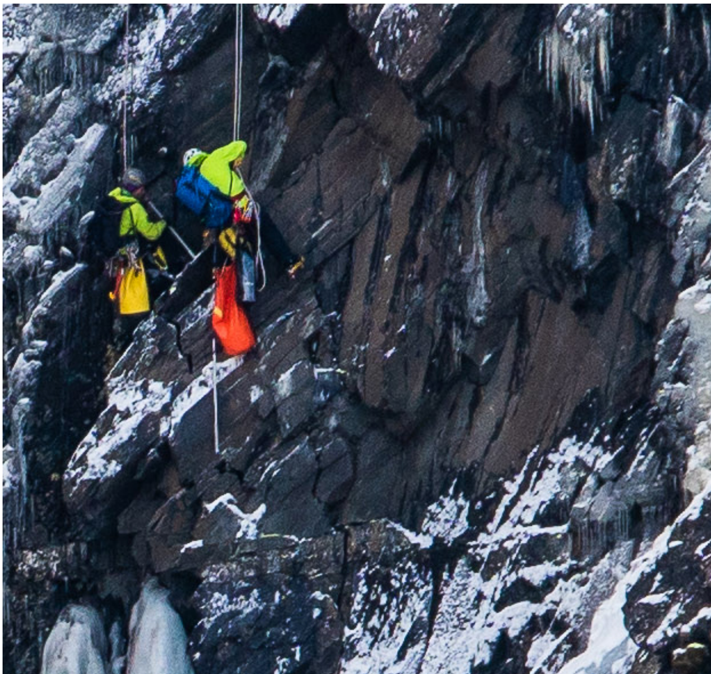
Området som raste ut. Brekke 7-9 meter, Høyde 5-6 meter, Dybde 1-1,5 meter: Opp mot 80 kubikkmeter stein (ca 200 tonn) løst anslagsvis fra stedet. Foto: Thomas Horgen/NARG
