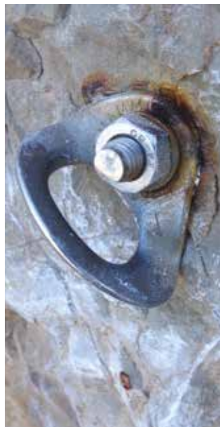
Rustet bolt. Eksempel på bolt som må byttes.
